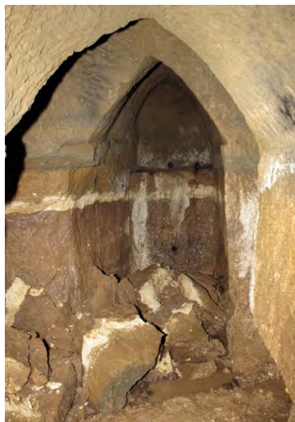
Fig. 4. Camera di captazione.
